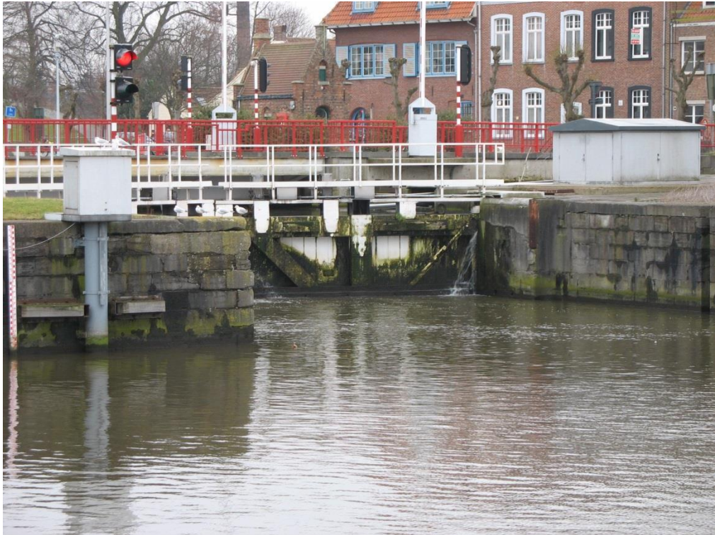
De Dampoortsluis te Brugge. Het grootste migratieknelpunt van SKP-Kanaal Gent-Oostende
